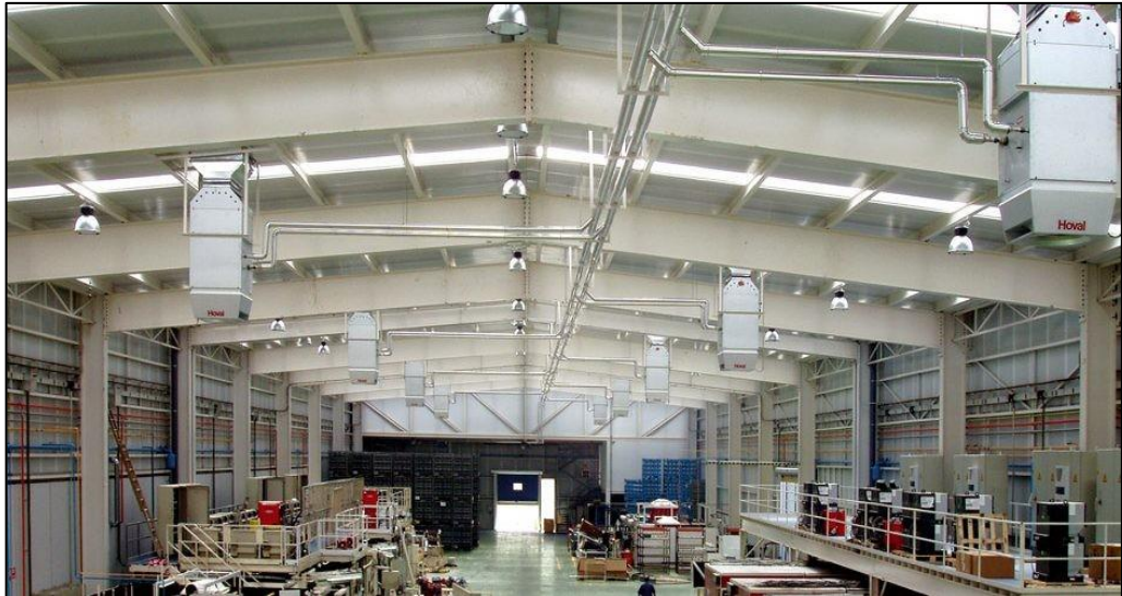
Figura 91. Ventilación mediante conductos
